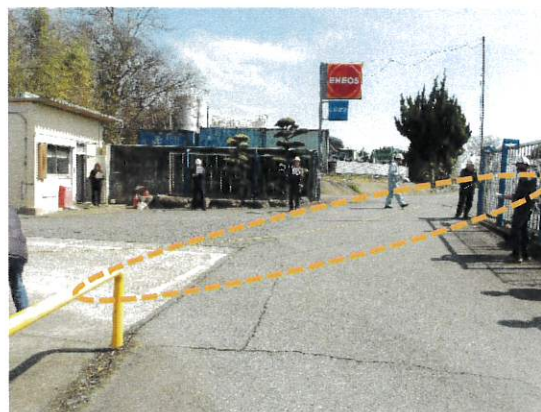
立入禁止措置（ロープ展張）
